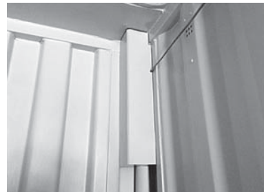
図 25. 電源ユニットを隠すハコ (コンテナ奥側)
